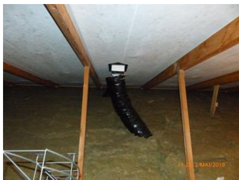
9.3 - Mangelfuld kondensisolering ved overgang til taghætte i bolig nr. 72.
