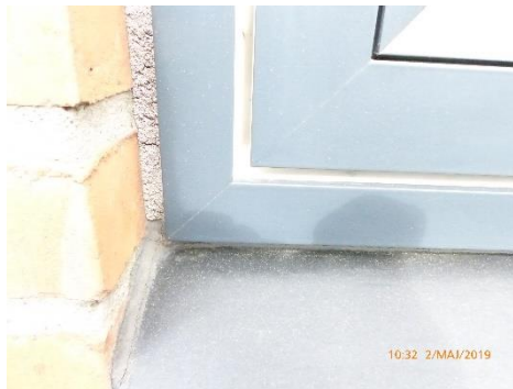
2.8 – Sålbank afslutning ved murværk, revnet fuge
