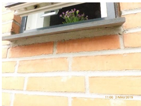
2.9 – Revne i mørtel under sålbæk
