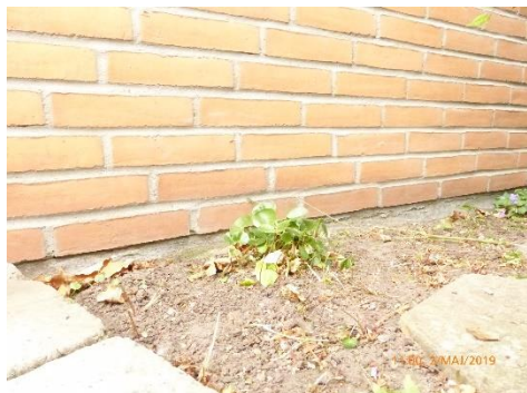
4.1 – Revne i sokkelpuds ved gavl
