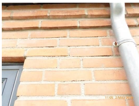
2.6 – Forvitrede fuger på haveside, bolig nr. 72
