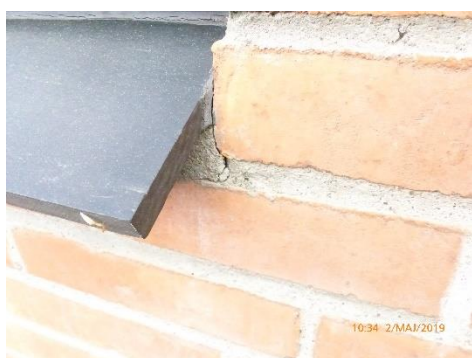
2.11 - Revne i mørtel under sålbæk
