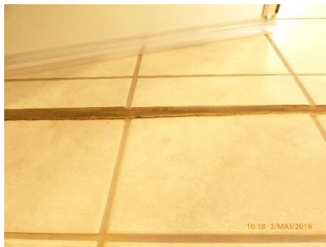
5.2 – Overgang bruseforsænkning med revne
