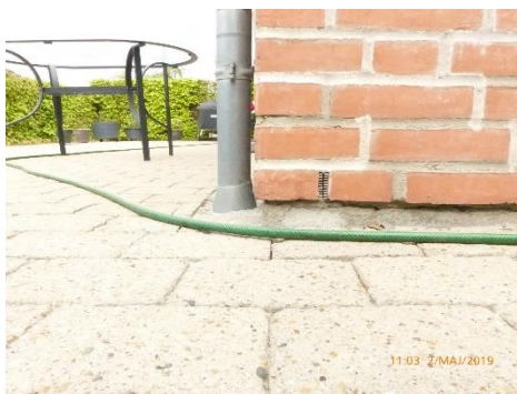
4.4 – Revne i sokkelpuds ved hjørne
