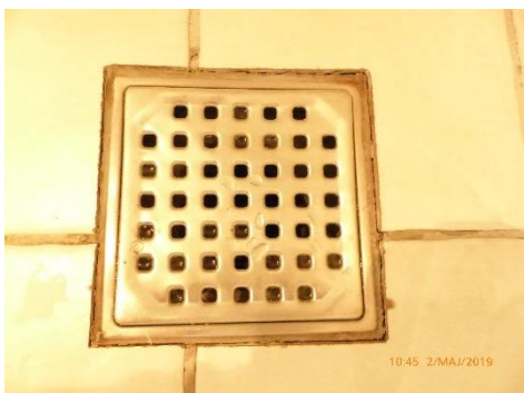
5.3 – Gulv afløb i bolig nr. 72 med revne i elastisk fuge
