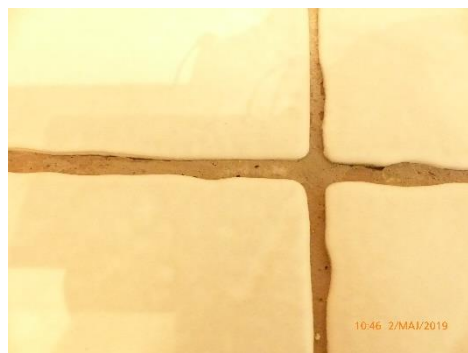
5.4 – forvitrede fuger i gulv i bruseniche i bolig nr. 72
