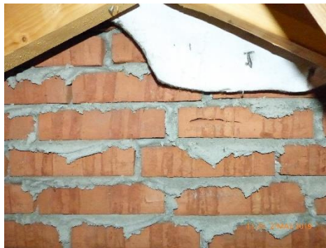
1.8 - Tagrum over bolig 56 – Undertag løs i gavl
