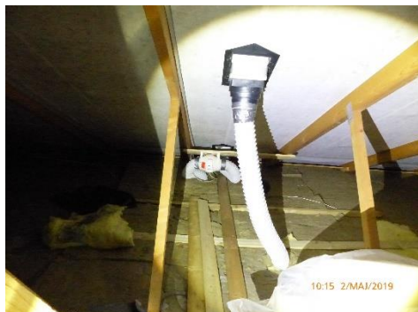
9.1 – Der mangler kondensisolering af flexslanger i bolig nr. 64
