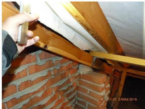
1.7 - Tagrum over bolig 56 – Undertag løs i gavl
