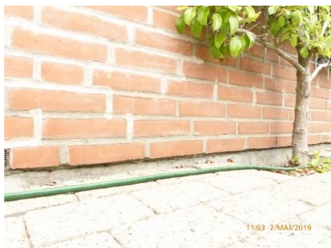
4.3 – Revne i sokkelpuds ved gavl
