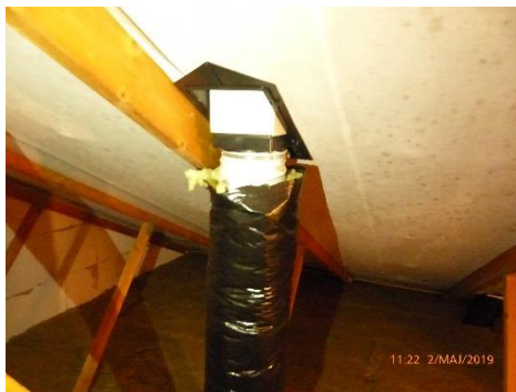
9.2 – Mangelfuld kondensisolering ved overgang til taghætte i bolig nr. 72.
