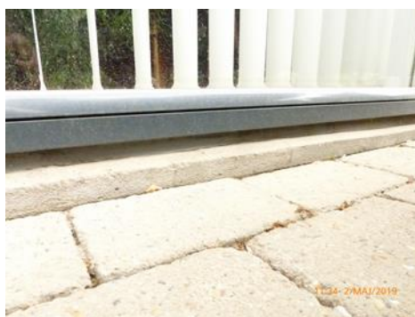
3.6 – Tilstand elastisk fuge ved sokkel
