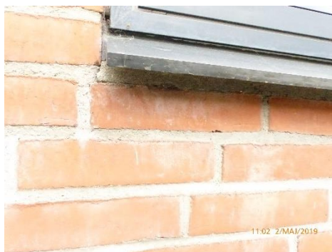
2.10 - Revne i mørtel under sålbæk
